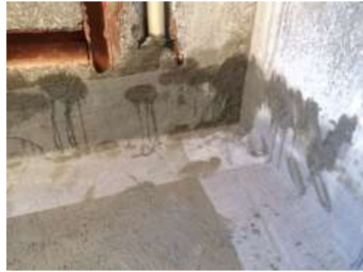
Figura 31 – Aplicação de tela poliéster sobre contrapiso impermeabilizado com argamassa polimérica (1ª demão).
