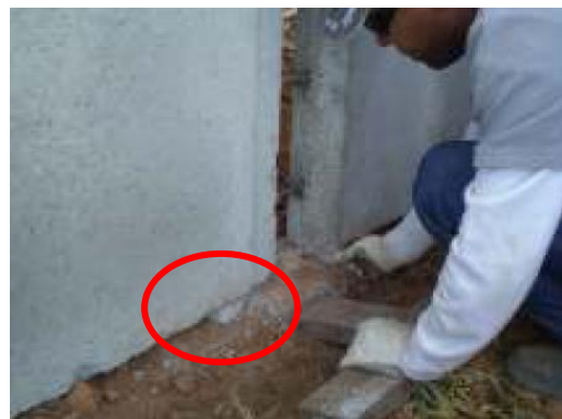
Figura 24– Calços de argamassa colocados nas interfaces entre painéis e fundações (ou lajes de piso) para substituir as bases de ferro fundido.
