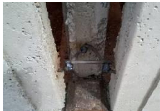
Figura 22– Detalhe da solda entre as armaduras de três painéis (junta em T)
